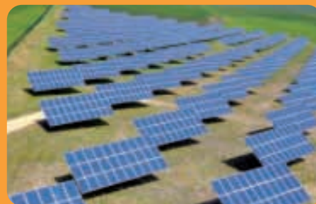
IMPIANTO FOTOVOLTAICO CON INSEGUITORI BIASSIALI IN PUGLIA 1 MWp
