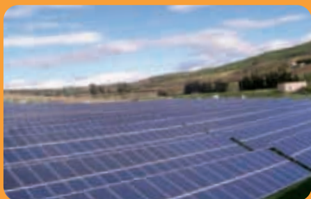
IMPIANTO FOTOVOLTAICO A TERRA IN SICILIA 1 MWp
