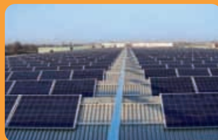
IMPIANTO FOTOVOLTAICO RETROVENTILATO 200 kWp
